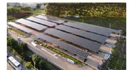
一汽丰田(长春)发动机有限公司停车场的太阳能发电板
